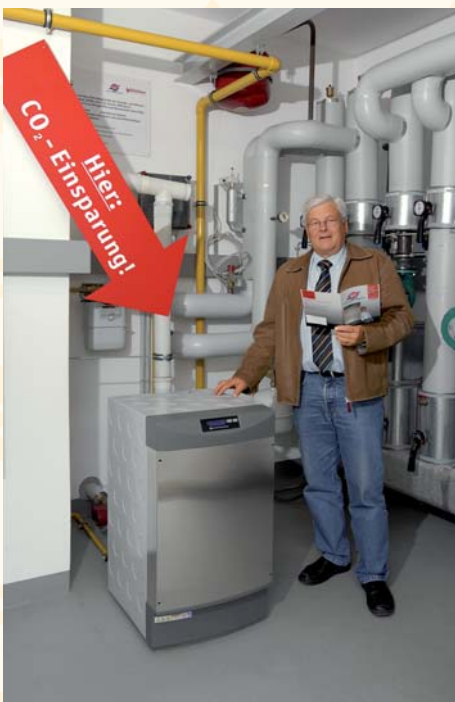
Strom erzeugende Heizungsanlage für Jedermann im Test
